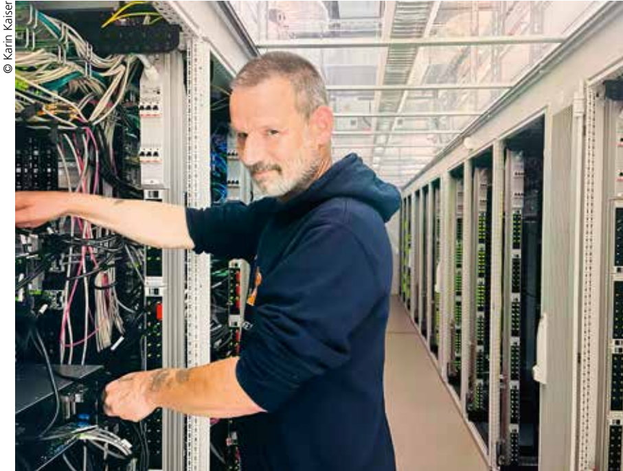
Zuständig für die Technik im Rechenzentrum: Alexander Lehr, Data Center Chief Engineer der MHH.
